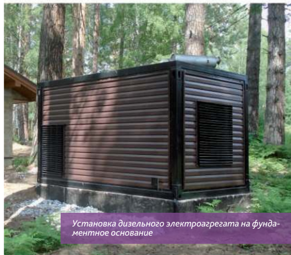
Блок-контейнер «Север» с ДГУ установлен на фундаментные блоки, промежуточный этап подключения контура заземления корпуса блок-контейнера
