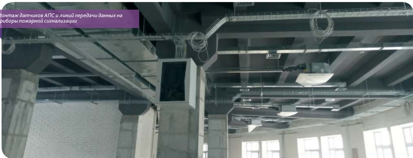
Блок контроля охранно-пожарной сигнализации
